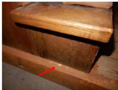
Abb.07: Nagekäfer-Befall mit Bohrmehl Innenraum
